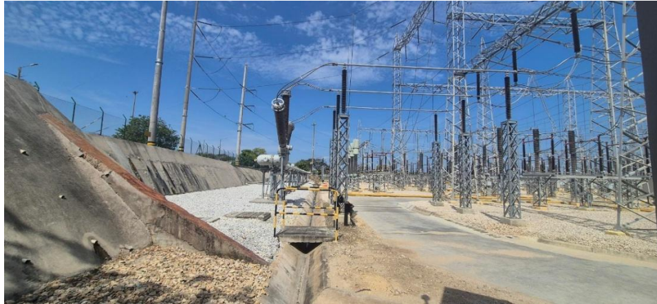
Figura 3. Foto 1 subestación TEBSA 220 kV
